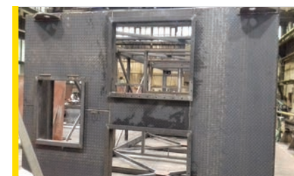
Ocelová konstrukce pro rekuperační jednotky
